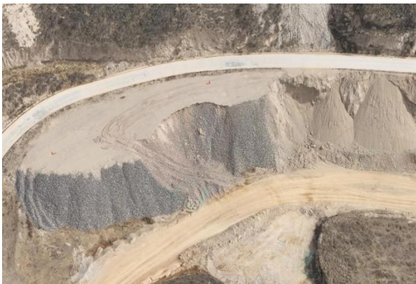
照片 3-6 X6 不稳定斜坡照片
